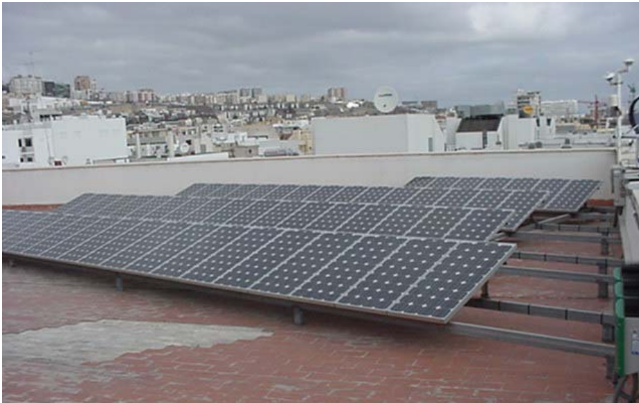
Figura 2. Instalación fotovoltaica de 4,5 kW en la sede del ITC de Las Palmas de G.C.
